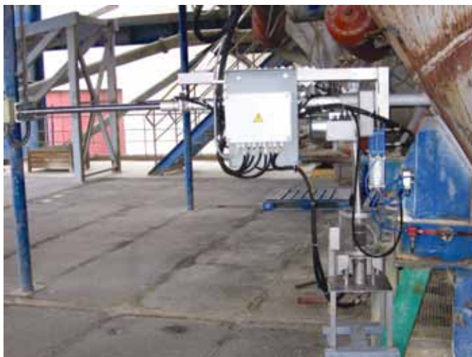
Рис. 12. Станция отбора проб сырьевой муки из нижней точки теплообменника (цементный завод Lafarge C&K, Чехия)
