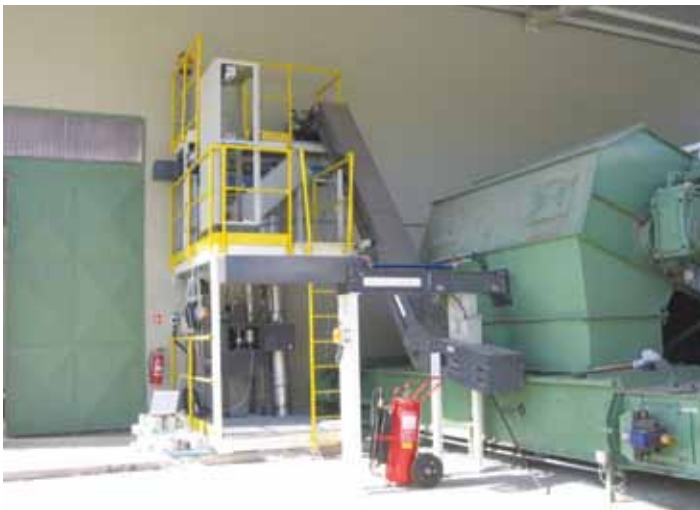
Рис. 14. Станция отбора проб твердых бытовых отходов (Českomoravský cement/HeidelbergCement, цементный завод Mokrý, Чехия)
